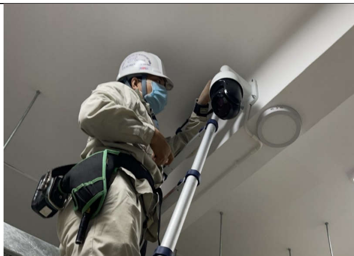
(Camera an ninh của các trạm điện)
